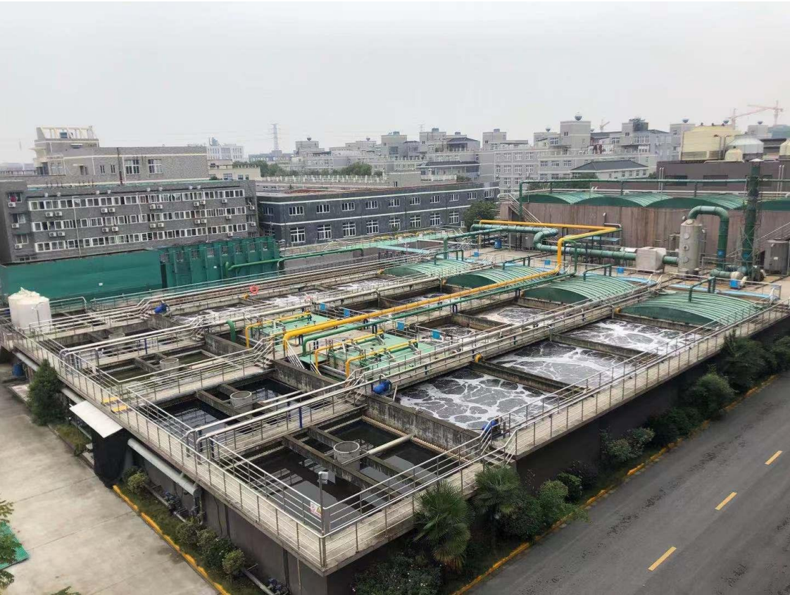
图4-2 废水处理设施图
