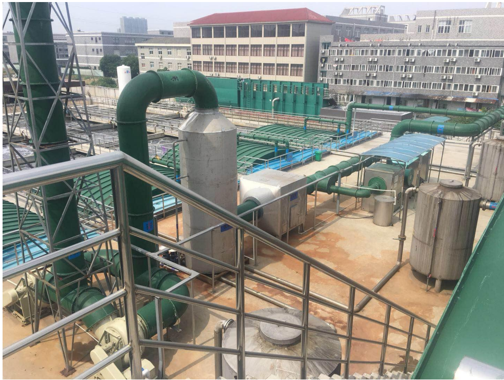
图 4-4 污水站废气处理设施
