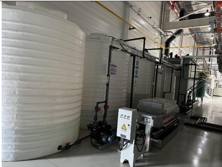
污水处理设施
