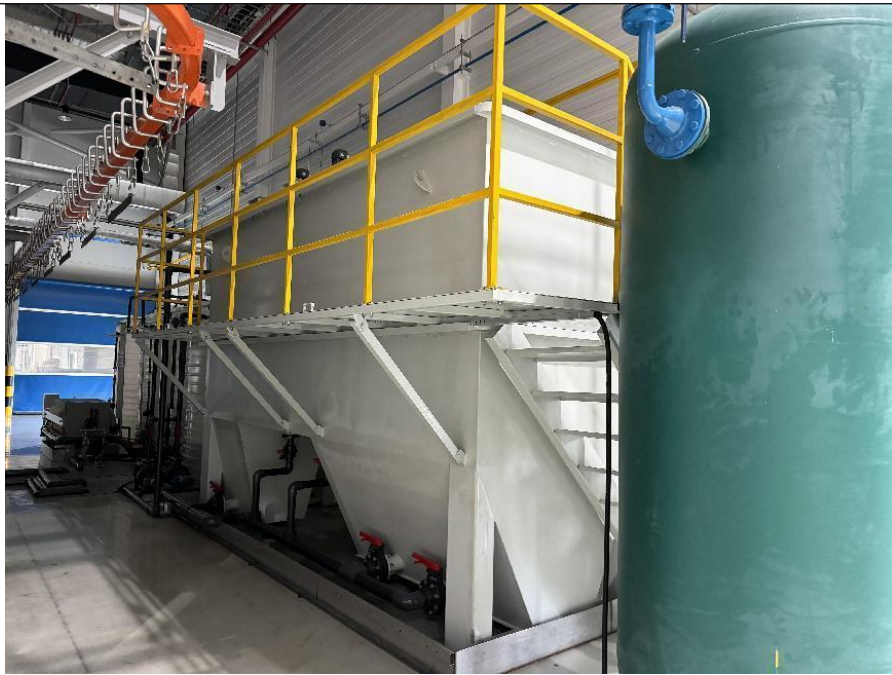
污水处理设施
